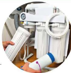
Sistema di purificazione a osmosi inversa per le acque domestiche.
