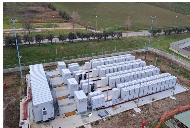
BESS – sistemi di stoccaggio energia a batteria
